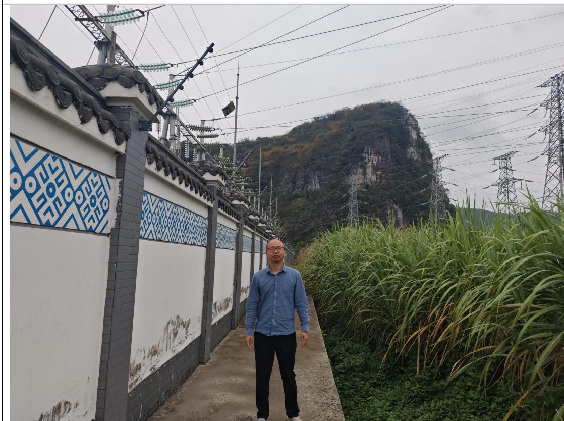
220kV 贝江变电站 110kV 出线侧
