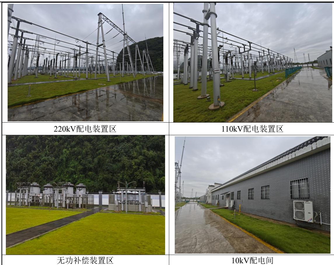
续图 2-1 220kV 贝江变电站站内建筑及电气布置情况现状照片
