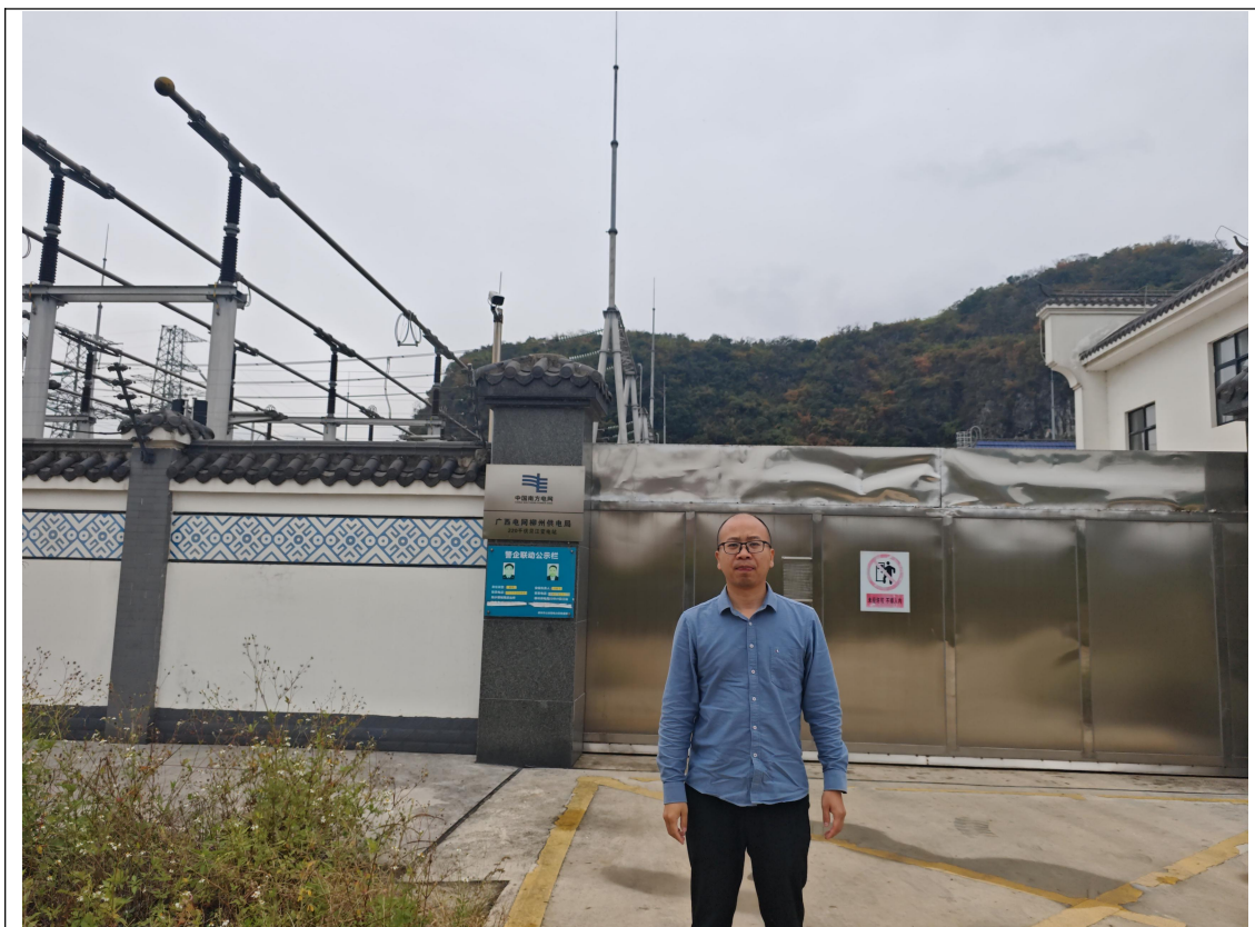
220kV 贝江变电站大门口
