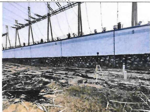
220kV 里明站东北侧 (偏西) 厂界围墙外 5m (D1)
