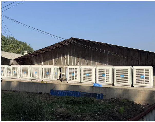
现有工程喷淋除臭装置
