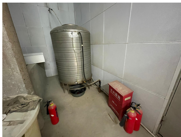
现有发电机房内柴油吨桶及灭火器等措施
